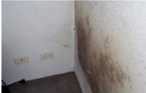
Grzyb w rogu pomieszczenia
